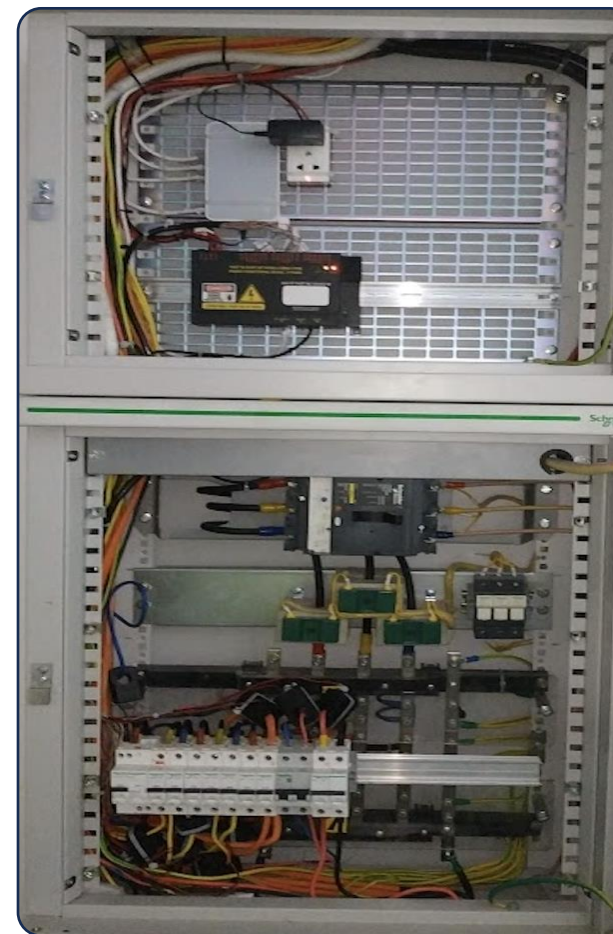
Hình ảnh lắp đặt thực tế
